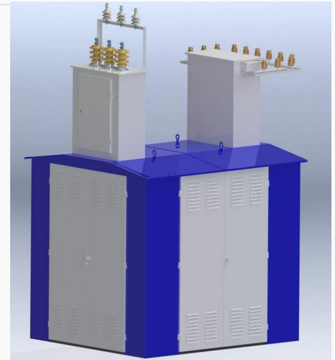
Трансформаторная подстанция киоскового типа
